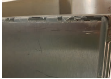
Abb. 6: Hohlkammerprofil (Dichtung) mit Beschädigung
